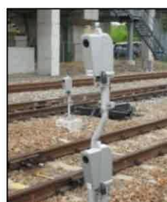
▲踏切障害物検知装置
