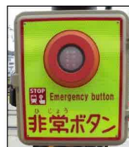
▲踏切支障放置装置
