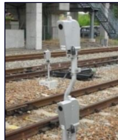
▲踏切障害物検知装置
