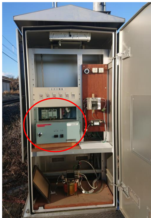
写真 2 列車無線基地局装置
