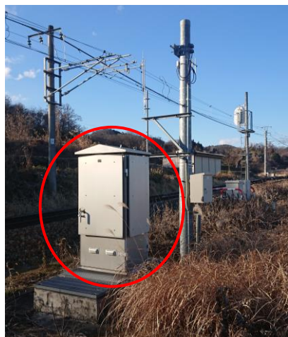
写真 1 列車無線基地局（全景）
